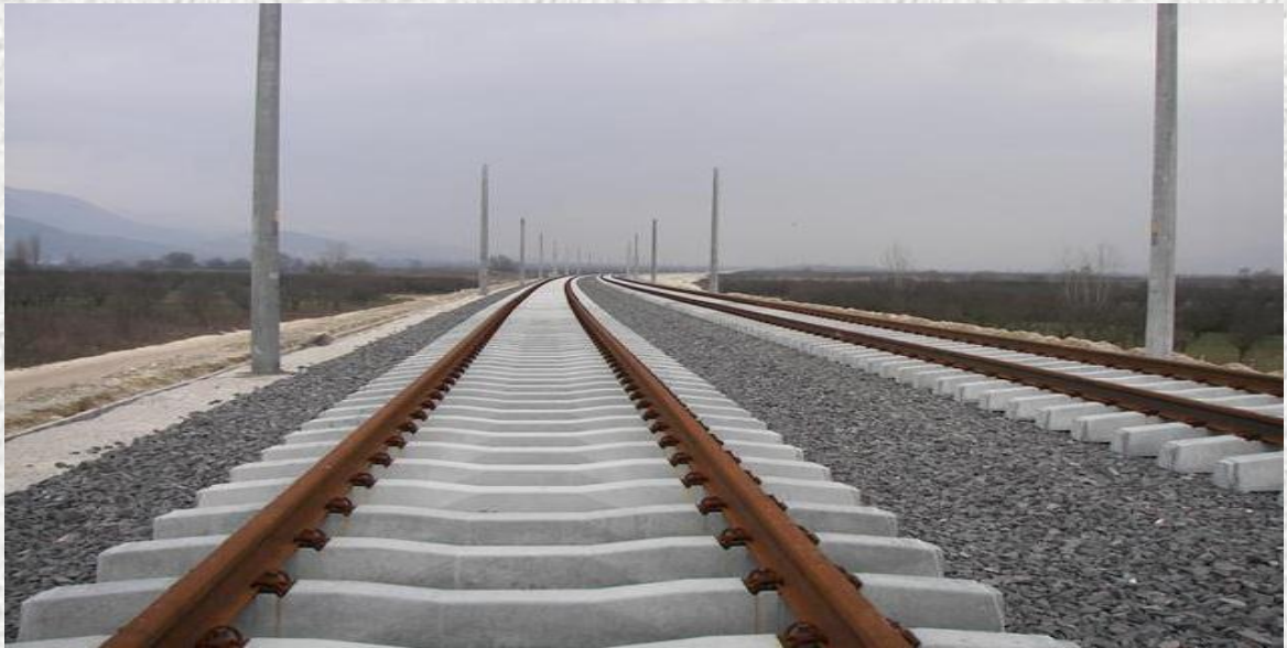
وینهی ( 4 ) داکوتانی هیلی ناسین له سهر پارچه کونکریتی ناماده کراو ( precast concrete )
